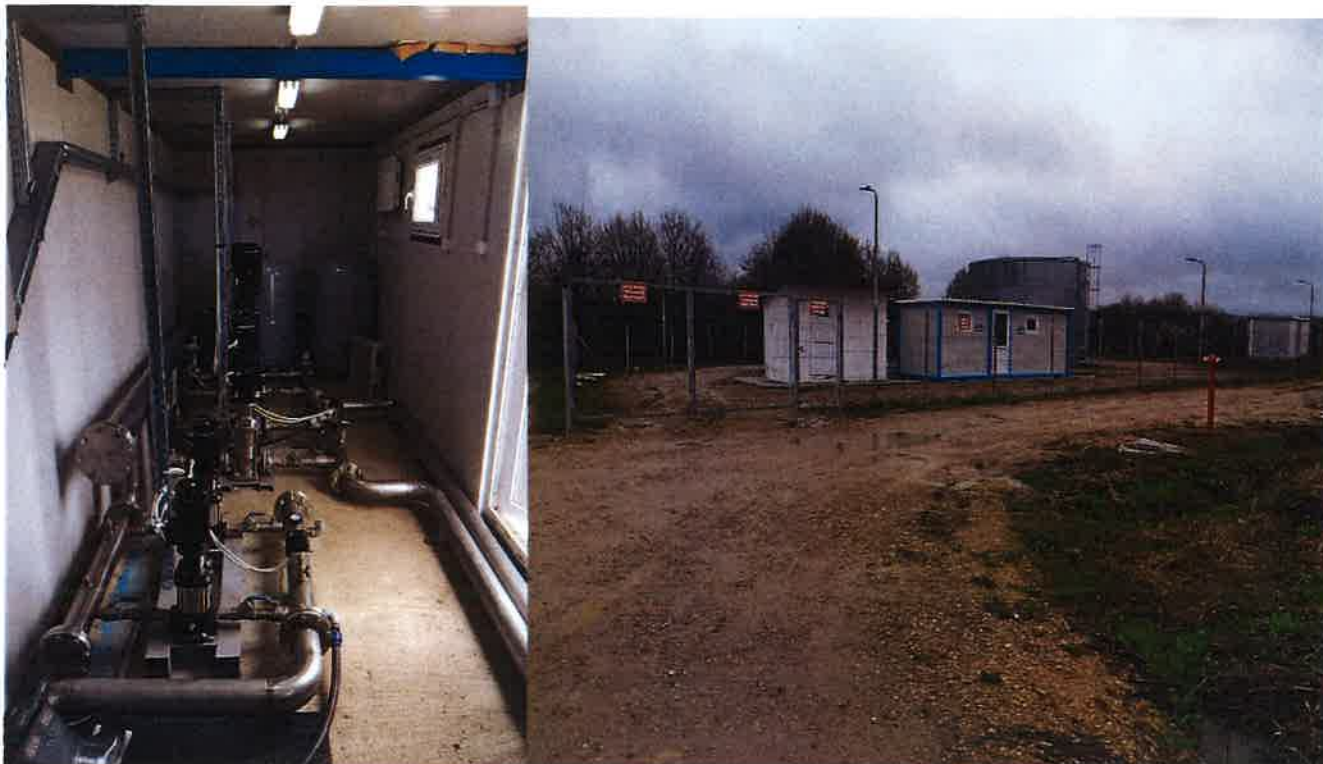
Fig.13 Stația de captare/pompare Alimentare cu apă Ursad-Poclusa de Beiuș
